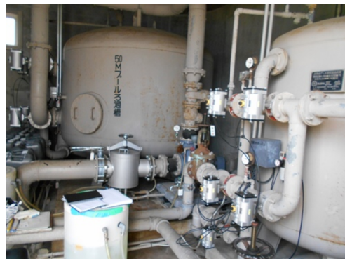
プールの水の循環ろ過装置
