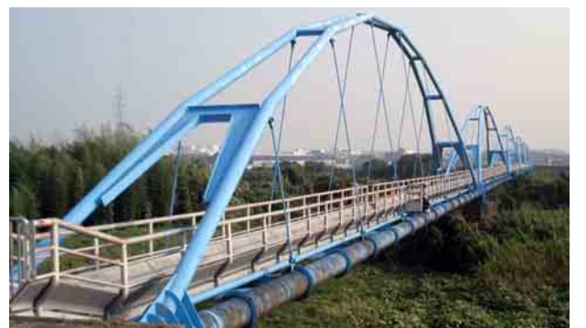
水道の動脈・平野水管橋(1971年建設)老朽化がすすんでいる
