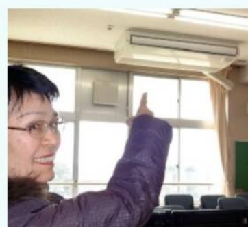
稲生小学校普通教室に設置されたエアコン
